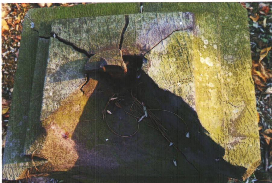
Fot. 1.2.6. Pęknięcia promieniste kamienia powstałe wskutek korozji osadzonego w nim żelaznego elementu
