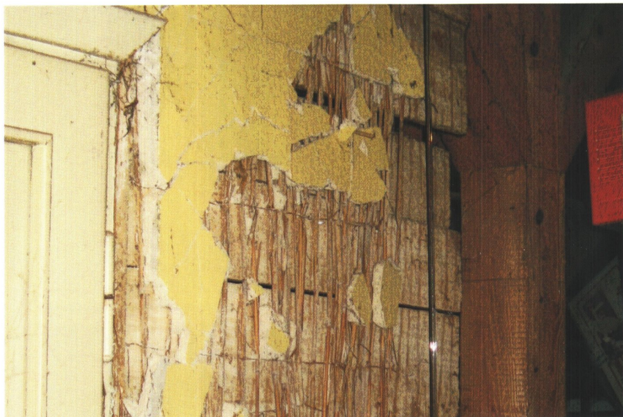
Fot. 3.3.5. Zniszczony tynk na podłożu drewnianym
