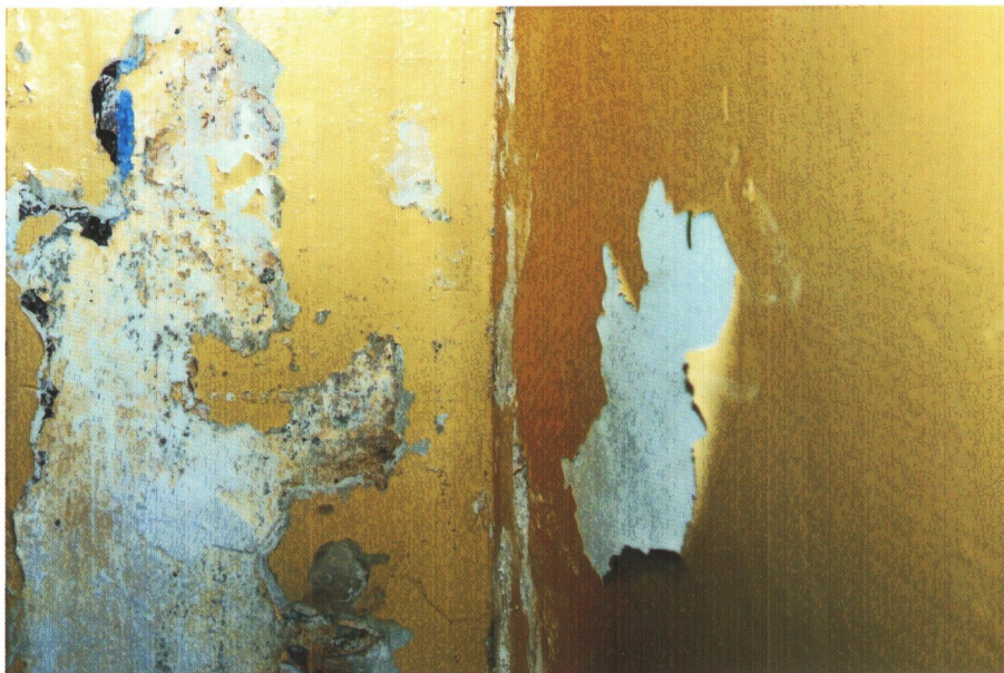
Fot. 1.2.2. Niszczenie tynku spowodowane zamknięciem porów przez powłoki olejne
