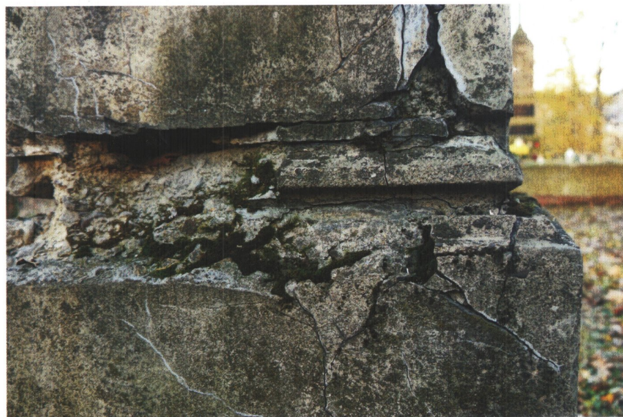
Fot. 1.2.3. Rozwarstwianie i złuszczenie betonu jako efekt działania zamarzającej wody
